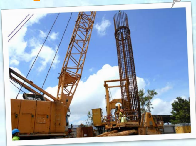
▲ 正在進行的地基建造成工程，上圖為鑽孔灌注樁的鋼筋籠安裝工序。
