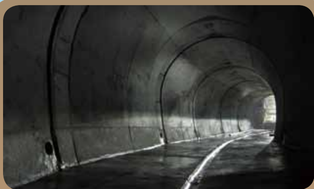
雨水經連接隧道流進主隧道
