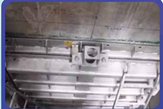
水閘用於維修期間阻隔地面徑流進入隧道
