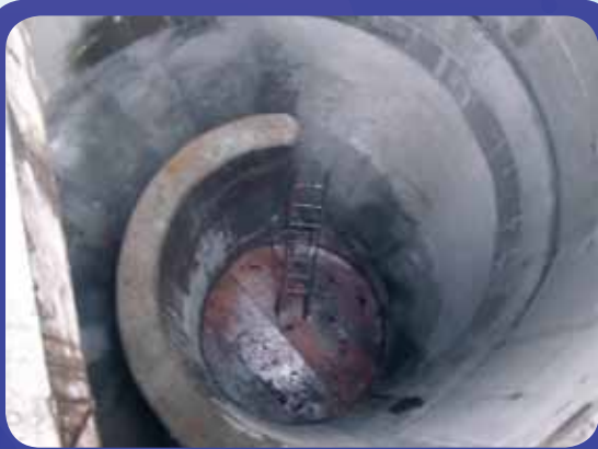
地面徑流流入豎井
