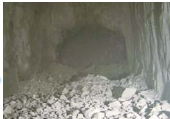
爆破後的隧道情況
