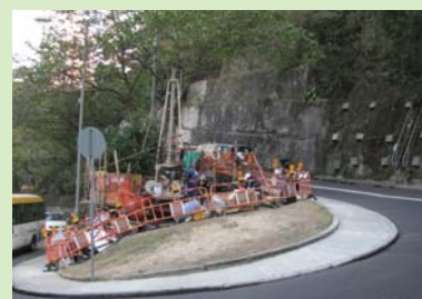
梅道進水口編號MA17前期工程的工地範圍，承建商已設置圍欄，以策安全
