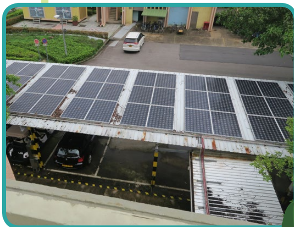
沙田污水處理廠的太陽能光伏板 PV Installations at Sha Tin Sewage Treatment Works
