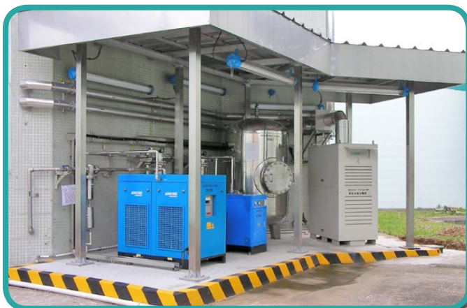
元朗污水處理廠的30千瓦微型渦輪發電機 A 30 kilowatt micro-turbine generator at Yuen Long Sewage Treatment Works
