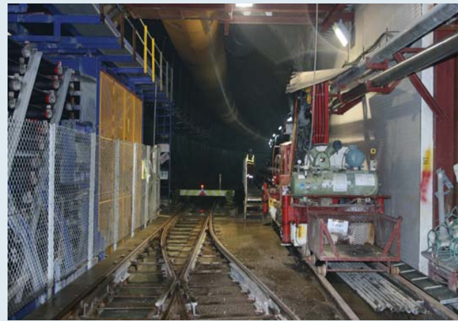
隧道內運輸帶組件及氣槽
