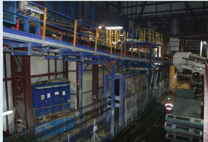
隧道入口處之運輸帶組件
