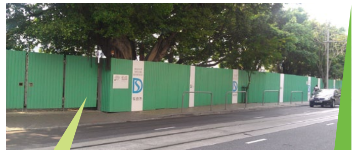
於黃泥涌道的通道井建造工程現正施工，四周亦已豎立圍板以保障公眾安全
