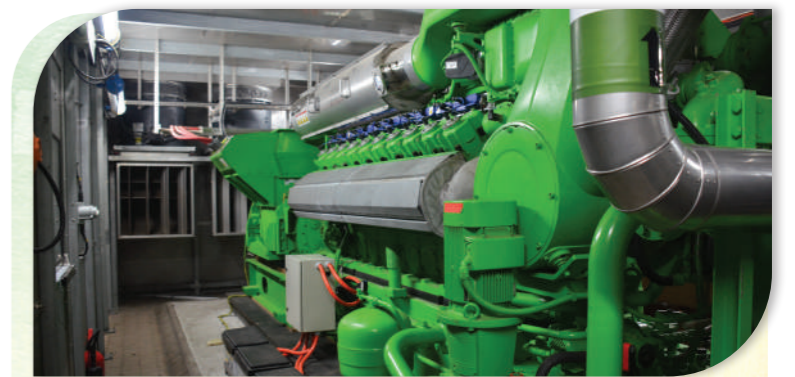
沙田污水處理廠的電熱聯供發電機 CHP generator at Sha Tin STW
