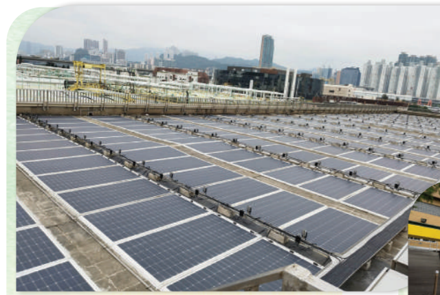
設於西北九龍基本污水處理廠的柔韌單晶硅太陽能發電系統
