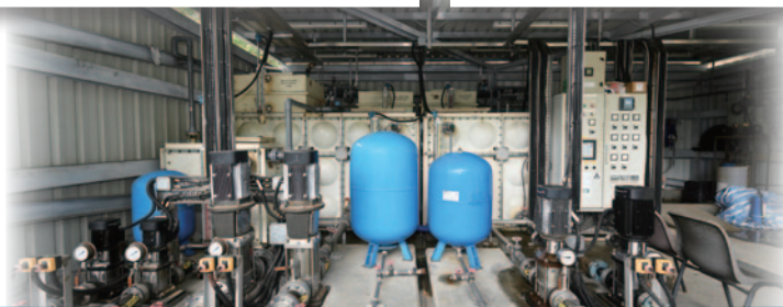
導賞團第三站 - 雨水收集及回用系統
